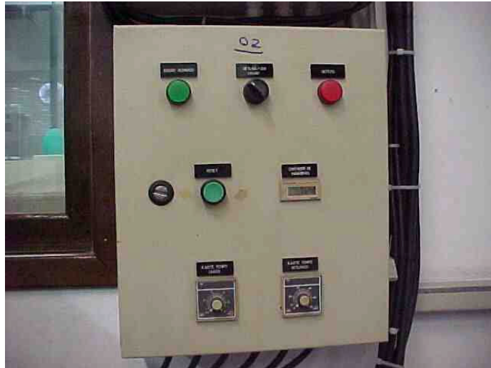
Figura 5.12 – Painel de controle para comandar os ciclos dos motores.
